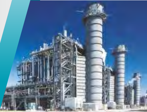
Heat Recovery Steam Generator ( HRSG )
